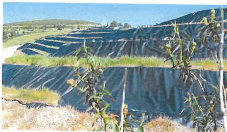
Figura 5 - Aterro Sanitário de Urjais – área selada.
