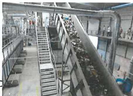
Figura 8 – Linha de Alimentação da UTMB.
