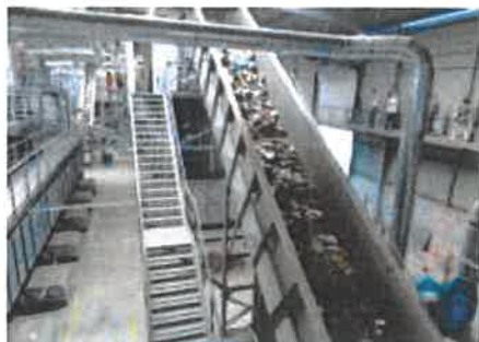
Figura 7– Linha de Alimentação da UTMB.
