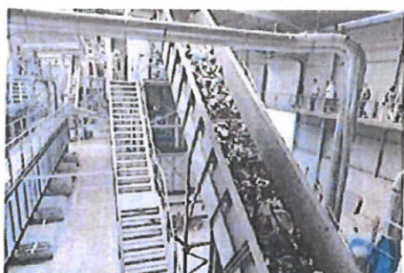
Figura 7– Linha de Alimentação da UTMB.
