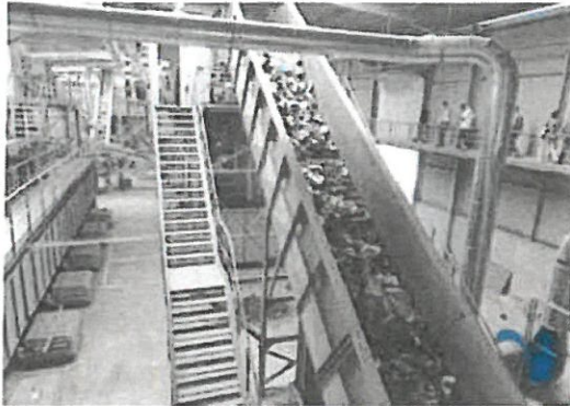
Figura 7- Linha de Alimentação da UTMB.
