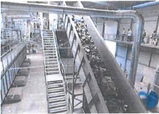
Fotografia 5 – Linha de Alimentação da UTMB.
